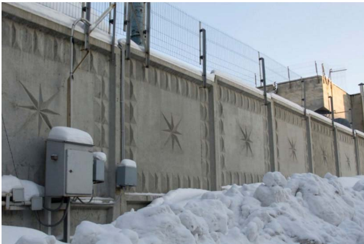
Рис. 2.1. Внешний вид емкостного СО, установленного на железобетонном заборе
