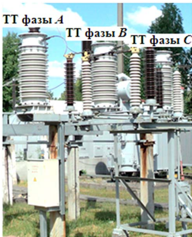
Рис. 38. Выносные трансформаторы тока ОРУ-110 кВ
