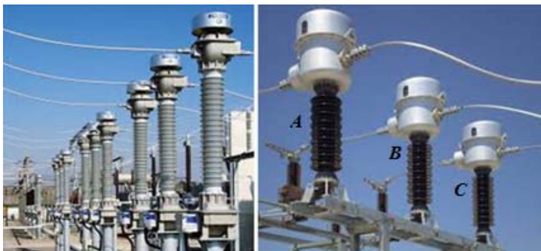
Рис. 41. Трансформаторы тока в схеме ФНП ОРУ-110 кВ
