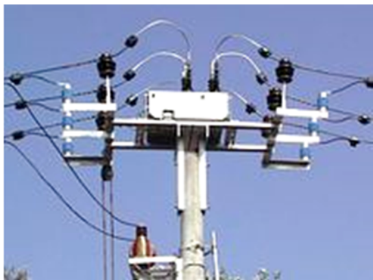
Рис. 7. Реклоузер РВА/TEL «Таврида Электрик» на опоре ЛЭП
