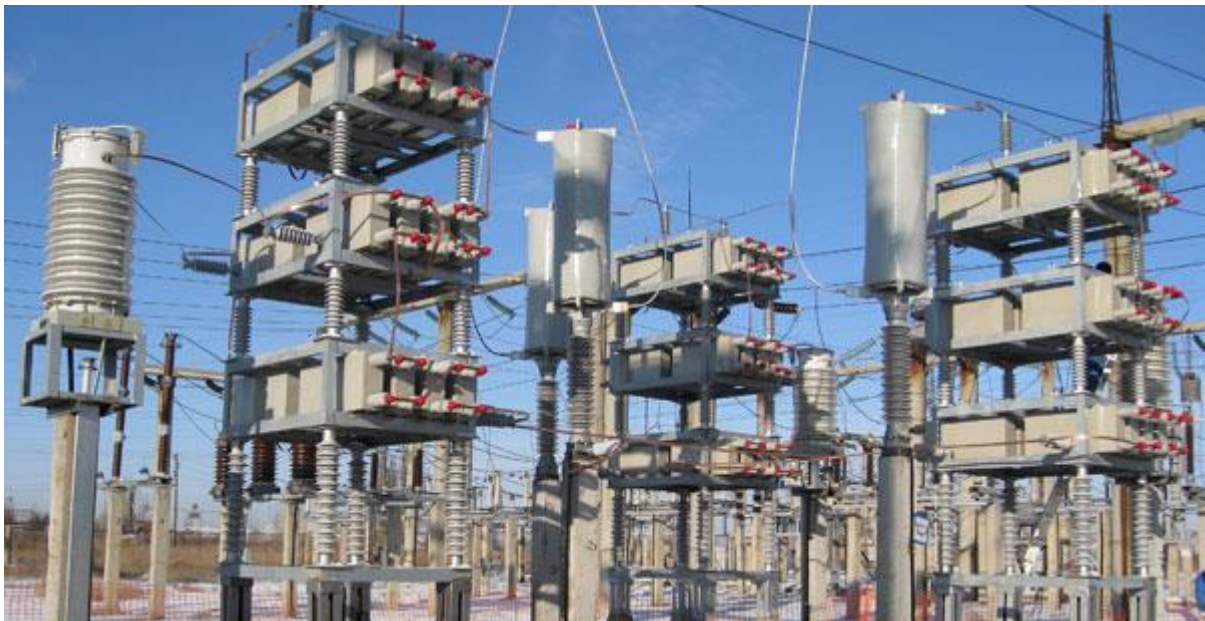
Рис. 82. Конденсаторная батарея установленная на подстанции
