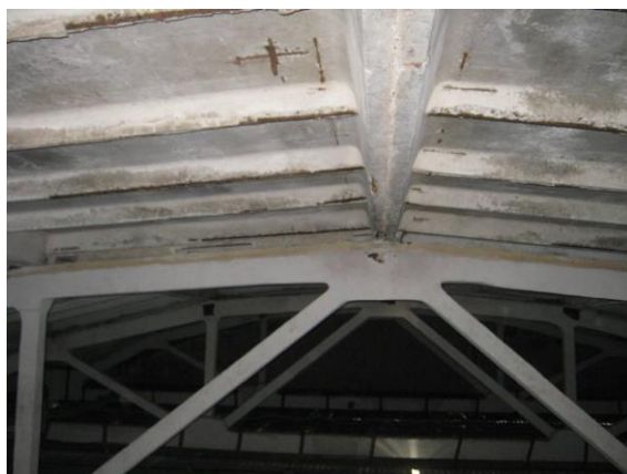
Рис. 1. Фрагмент ферм и плит покрытия. Отслоение защитного слоя бетона поперечных ребер с последующим провисанием и коррозией арматуры. Отслоение защитного слоя бетона у полок плит покрытия
