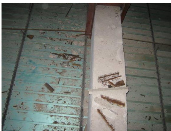
Рис. 3. Фрагменты обрушившегося бетона плит, уложенного на нижний пояс ферм при осмотре
