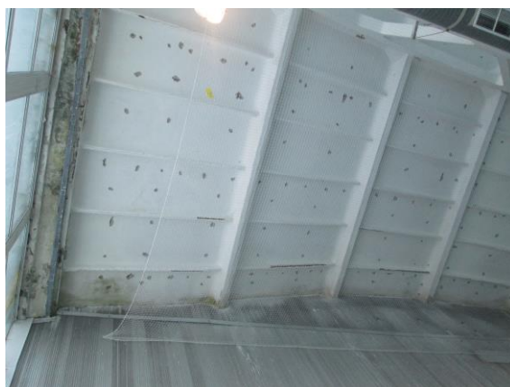
Рис. 4. Отслоение бетона полков плит покрытия из-за пробивки анкерами при ремонте кровли на плавательном бассейне по ул. Мира 59
