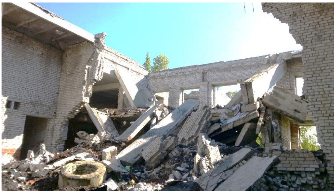
Рис. 2. Обрушение конструкции здания
