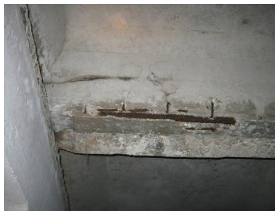
Рис. 2. Нарушение защитного слоя бетона в приопорной зоне плиты с последующей язвенной коррозией арматуры. Трещины по поперечной арматуре
