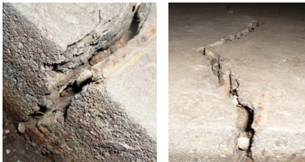
Рис. 8. Образование трещин (разломов) в опорной плите ВПТ-ПК
