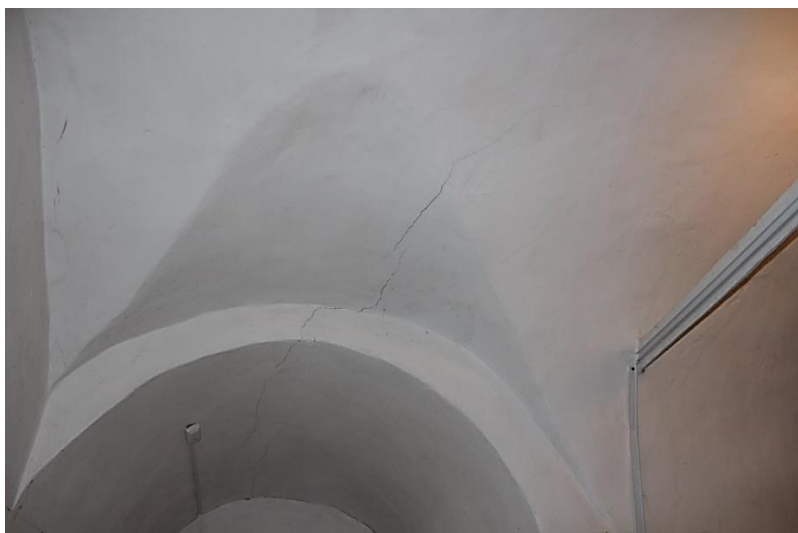
Рисунок 4 – Продольные трещины в сводах второго этажа
