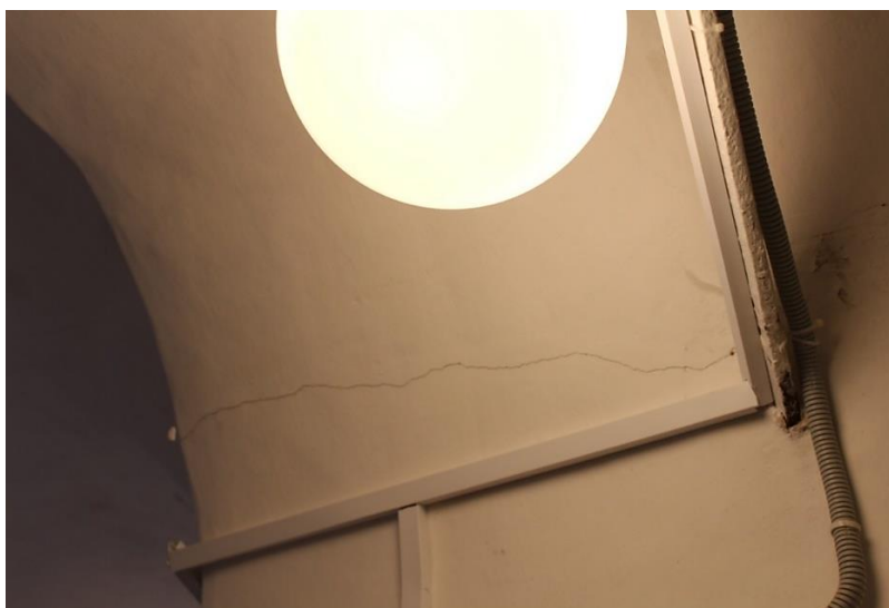
Рисунок 5 – Трещина в кладке пяты свода второго этажа
