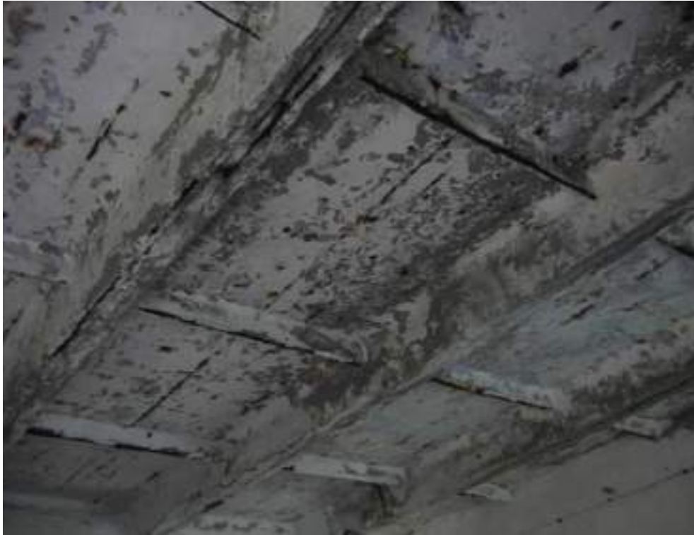
Рисунок 9 – Аварийное состояние плит
