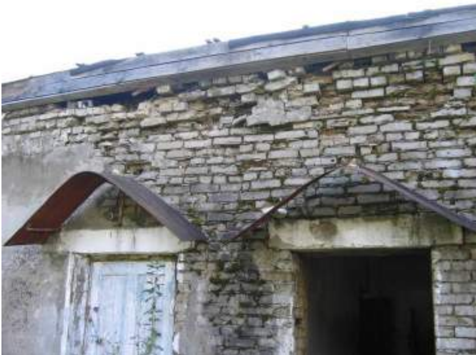
Рисунок 11 – Деструктивные повреждения кирпичной кладки котельной
