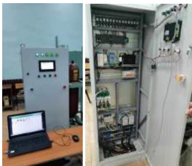
Рисунок 4 – рабочее место оператора, шкаф управления
