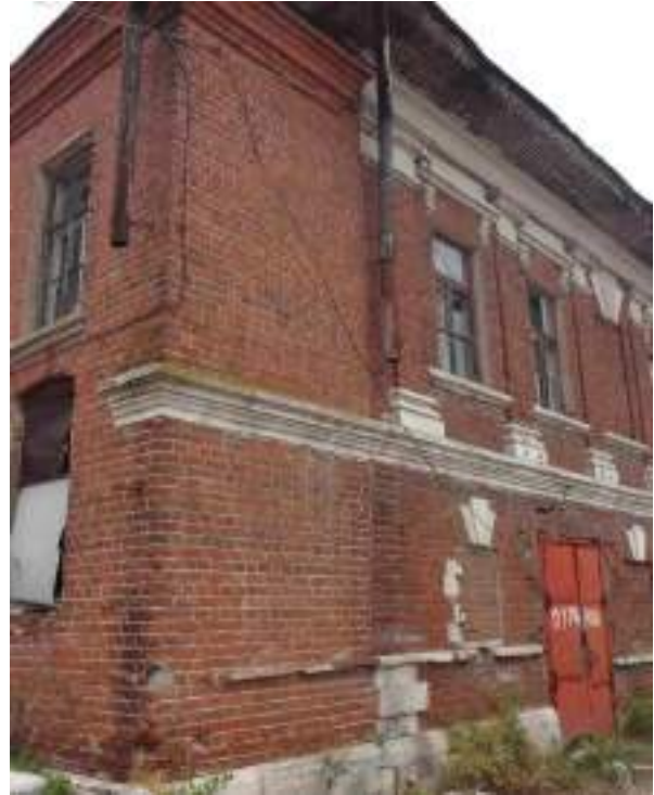
Рисунок 4 - Северный фасад здания. Выявлена утрата декоративных элементов, желобов
