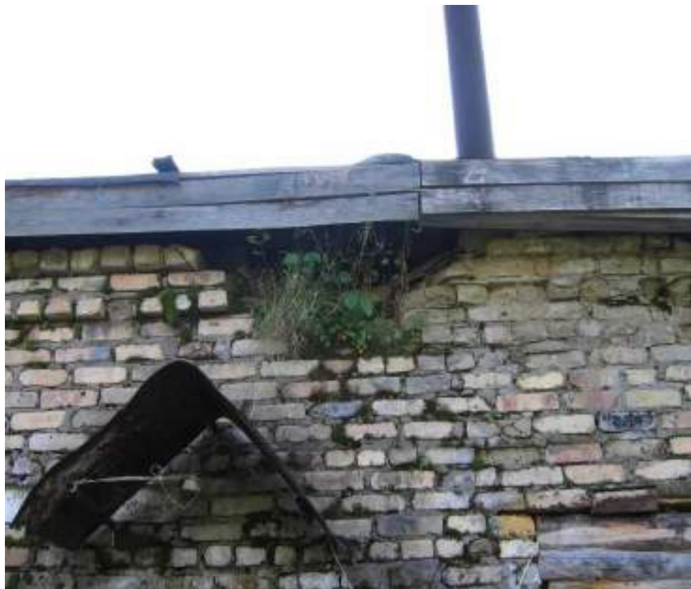
Рисунок 13 – Биоповреждения кирпичной кладки
