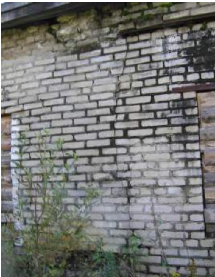
Рисунок 14 – Трещина в кирпичной кладке котельной с шириной раскрытия 5 мм
