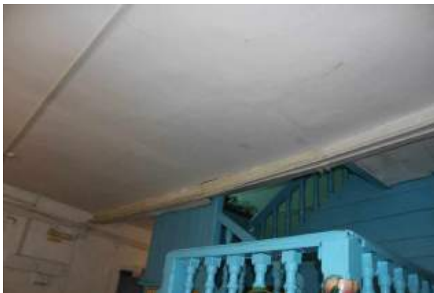
Рисунок 4 – Фрагмент сопряжения элементов лестницы с балкой перекрытия первого этажа. Прогиб балки перекрытия более 100 мм (помещение 4 на плане этажа)
