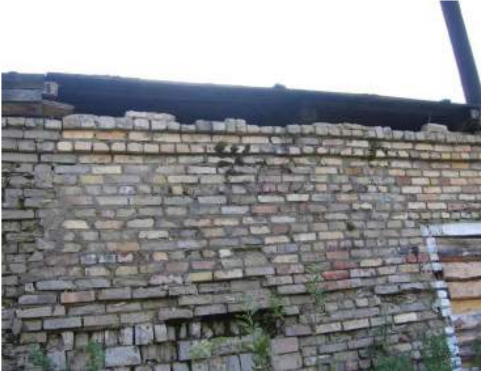
Рисунок 12 – Разрушение карнизной части котельной
