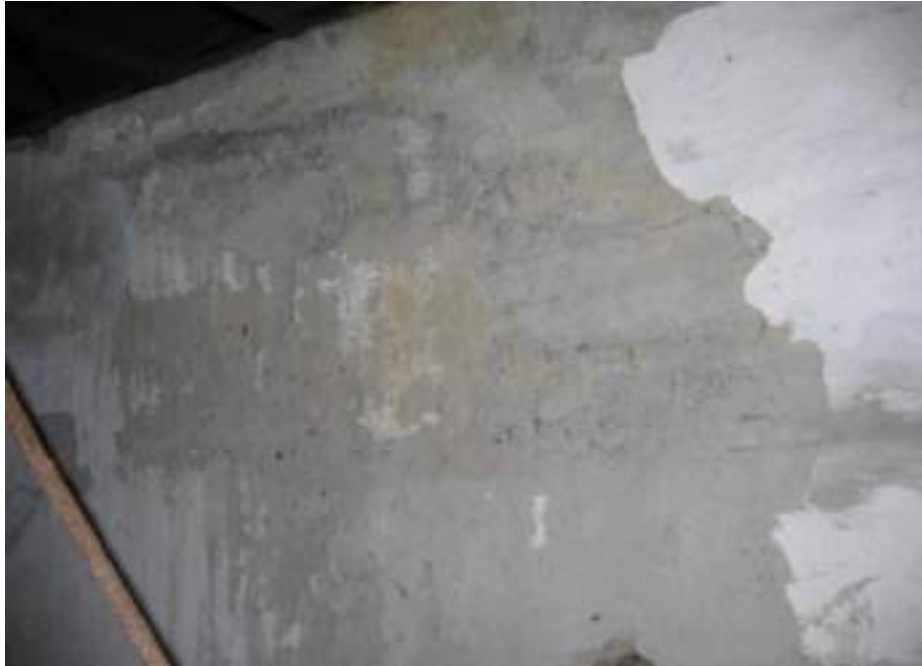
Рисунок 18 - Разрушение штукатурного слоя 1-ой секции
