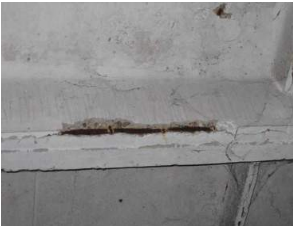
Рисунок 6 - Оголение и коррозия рабочей арматуры продольных ребер плит
