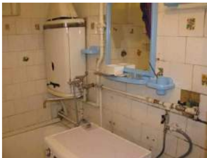
Рисунок 1 – Газовый проточный водонагреватель с открытой камерой сгорания, установленный в ванной комнате
