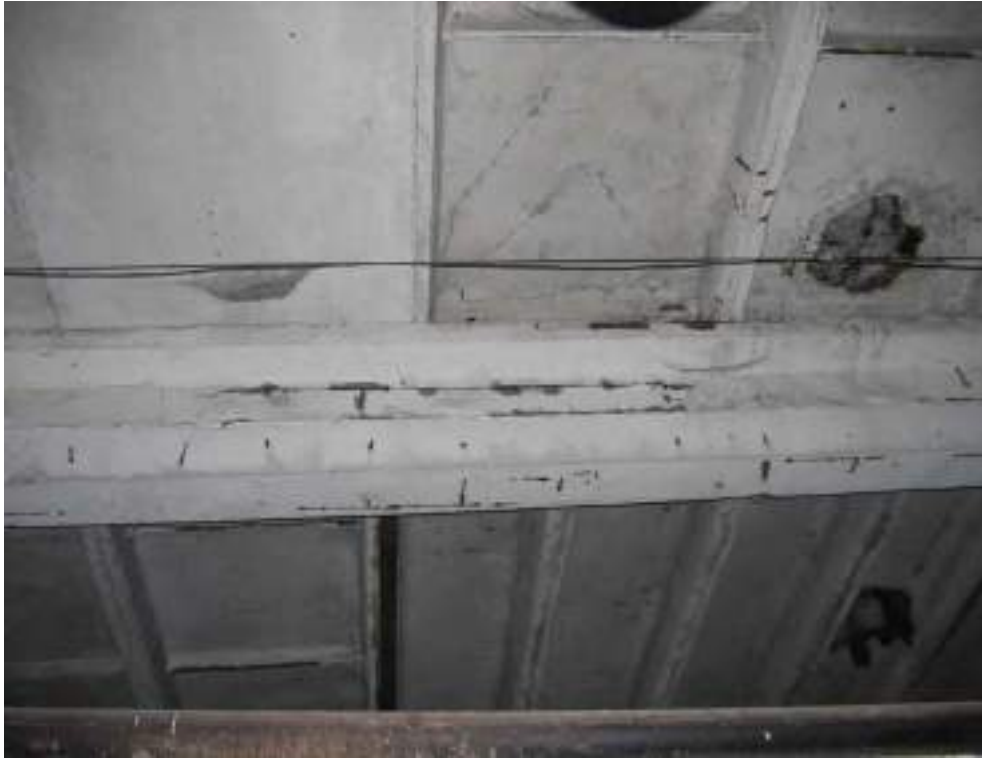
Рисунок 7 – Коррозия связевой арматуры в балках и плитах
