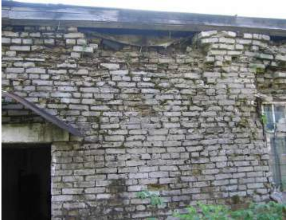
Рисунок 10 – Обрушение кирпичной кладки карнизной части в котельной
