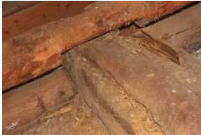
Рисунок 8 – Загнивание балки на глубину до 100...150 мм сверху и сбоку поперечного сечения в зоне опирания на стену по оси Д в осях 1-2
