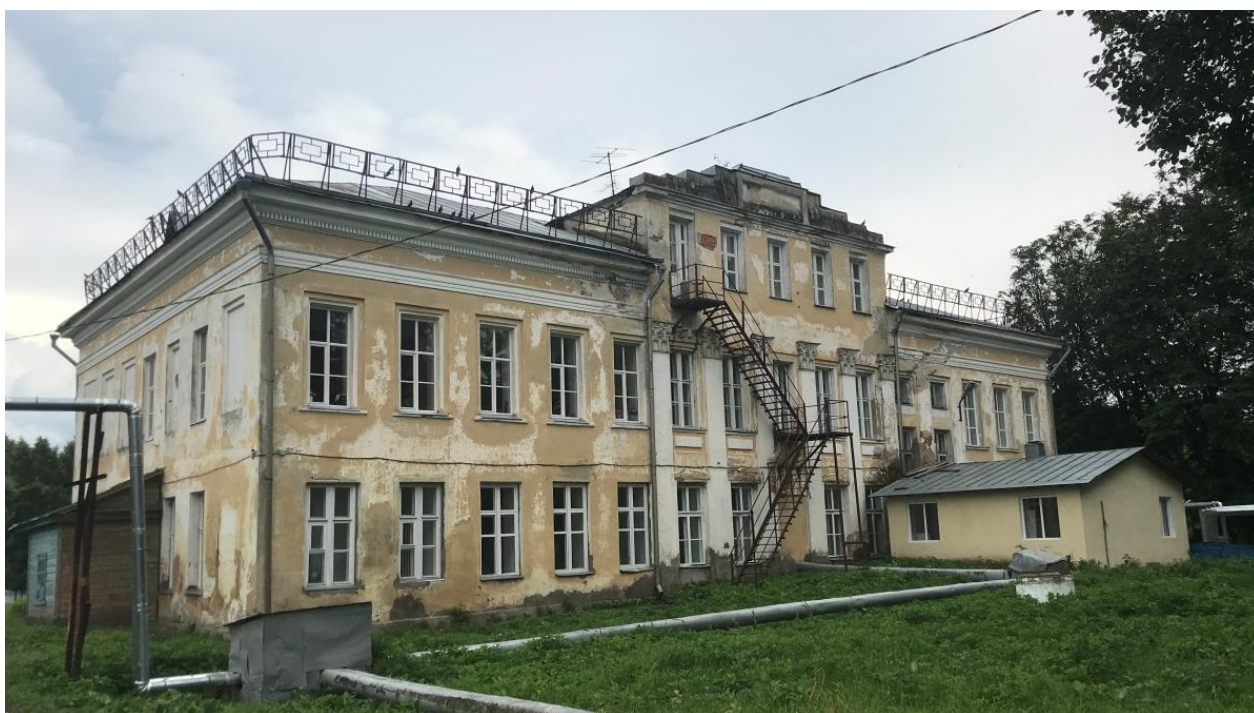
Рисунок 3 - Общий вид северного (дворового) фасада. Выгорание окрасочного слоя на всех площади фасадов, локальное разрушение штукатурного слоя. Деструкция кладки в местах отсутствия штукатурного слоя на фасадах
