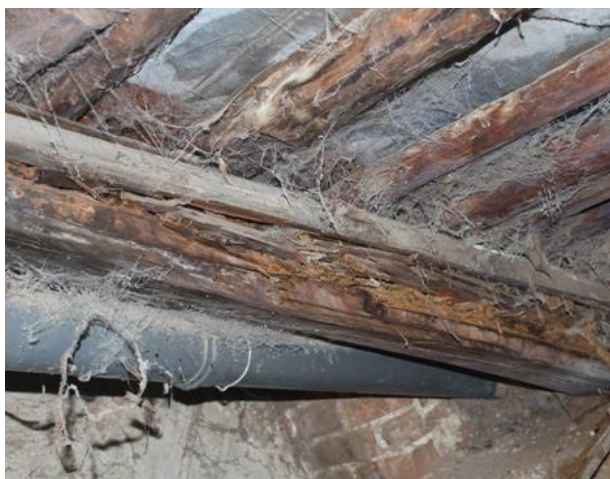
Рисунок 9 - Фрагмент аварийной стропильной ноги. Трухлявая гниль на всю высоту поперечного сечения
