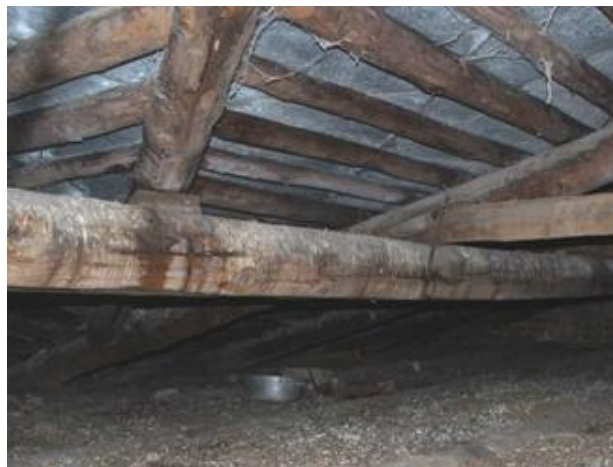
Рисунок 5 - Фрагмент стропильных ферм с повышенной затяжкой в осях (4-6/1)/(Б-В). Следы протечек кровли в зоне ендовы
