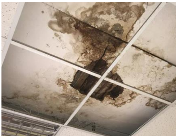
Рисунок 4 - Следы намокания чердачного перекрытия в осях 5-6/Б-В вследствие протечек кровли. Разрушение штукатурного слоя, вздутие листов в отделке потолка, начальная стадия загнивания дощатого настила чердачного перекрытия
